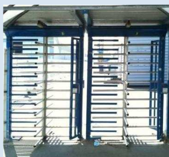
Tourniquets Kentaur installés aux différents points d'accès du site.
